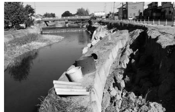
▲台風12号による破損箇所(水上橋下流左岸)
