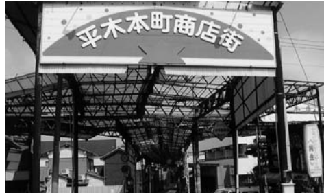
▲老朽化が進むアーケード
