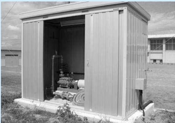
▲自己水源・田中小学校ポンプ井戸
