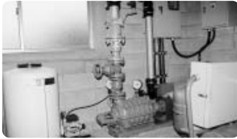
▲自己水源のポンプ施設(山大寺)
