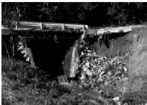
▲早急に災害復旧工事が待たれる（町道風呂谷線）
